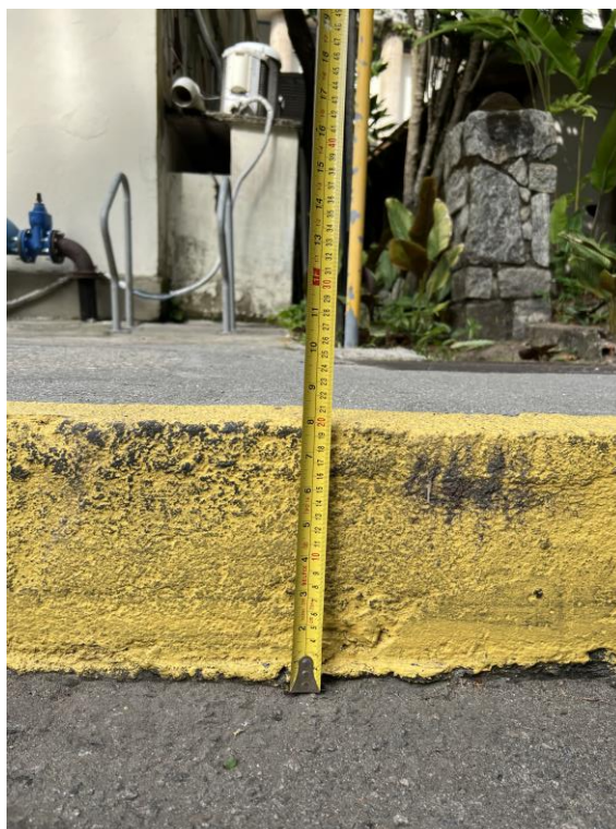
Figura 52 - Medição do desnível de 20 cm entre a rua e a calçada na PUC-Rio. Fonte: Autores
